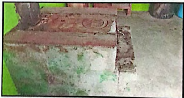
Foto 5: plancha en mal estado agrietadas
