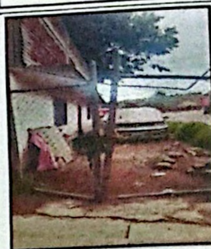
Foto 8: Porton en mal estado
