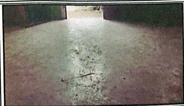
Foto 7: piso con grietas
