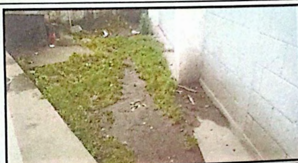
Foto 12: piso con acumulacion de charcos.
