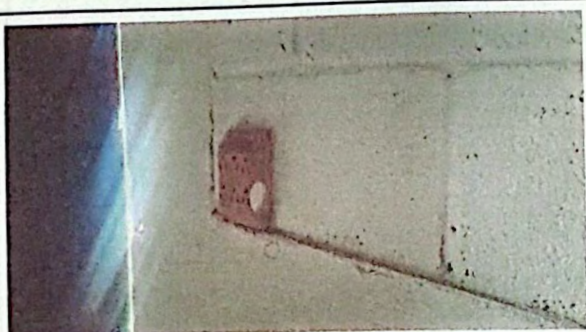
Foto 11: tomacorriente en mal estado
